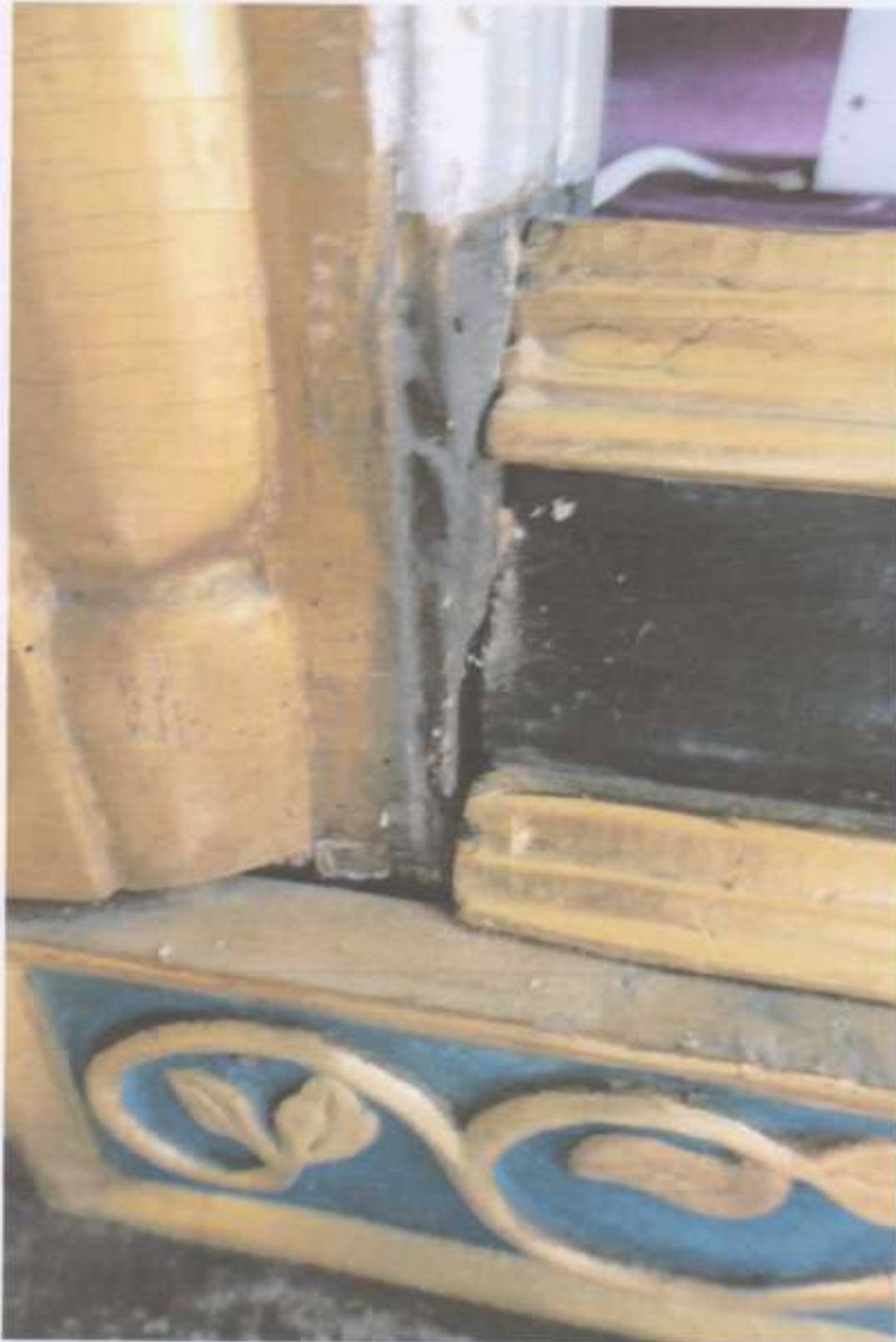
49. Predella. Stan zachowania. Widoczne szczeliny w miejscach łączy.
