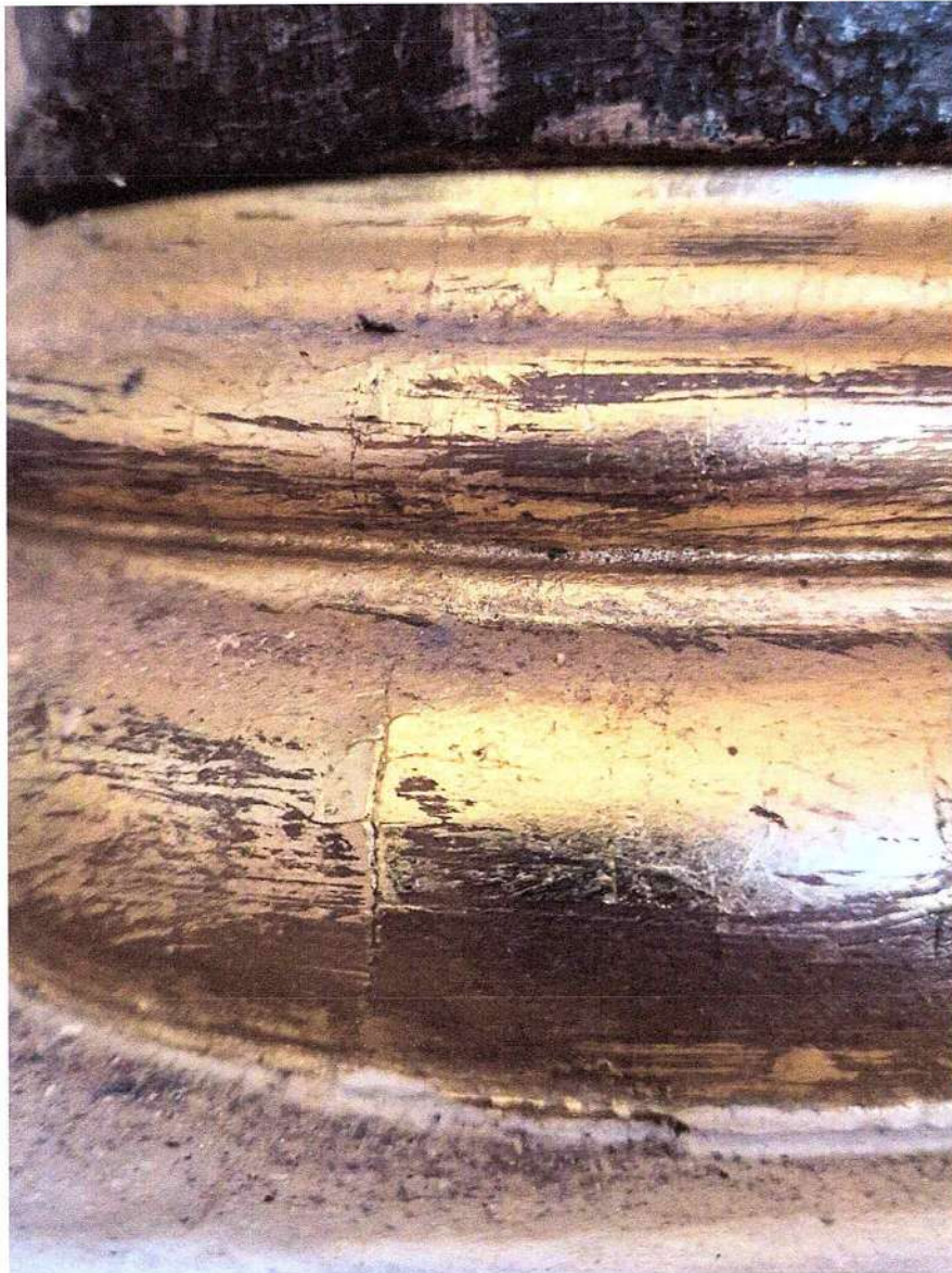
16. Cokół kolumny widoczna destrukcja gruntów i współczesne złączenie szlagmetalem
