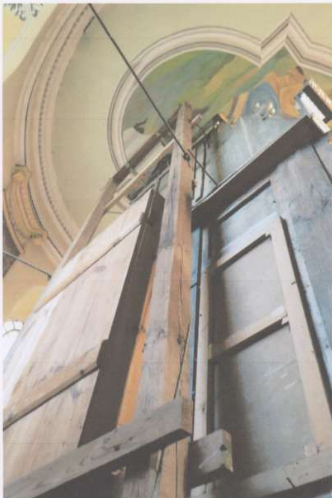
19. Odwrocie ołtarza. Strona lewa. Widoczna nowa konstrukcja nośna, nowa skrzynia ołtarzowa, nowy blejtram obrazu.
