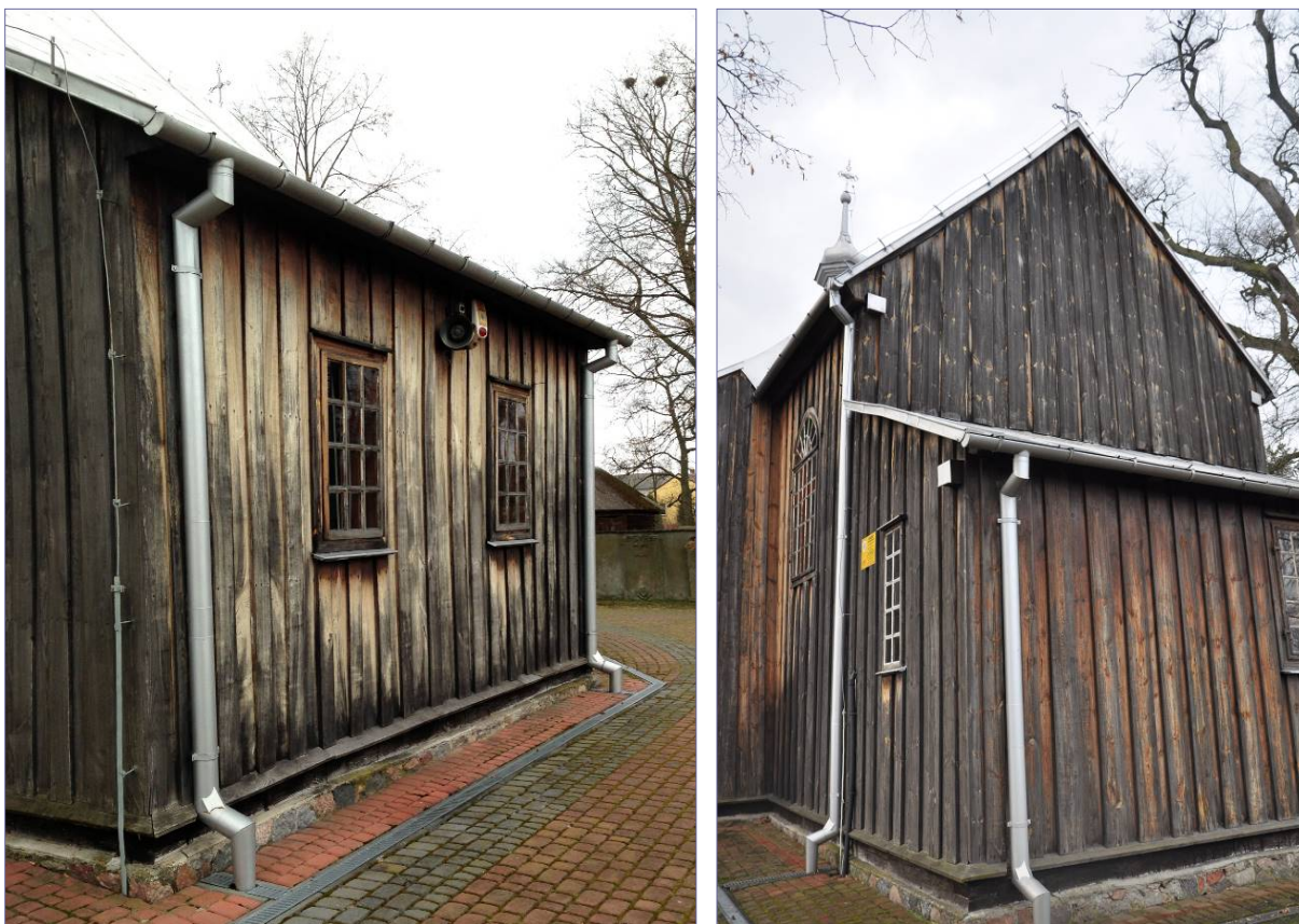
zniszczenia szalunku elewacji kościoła - spękania desek, wypłukanie barwników, stan techniczny, kamiennej podmurówki
