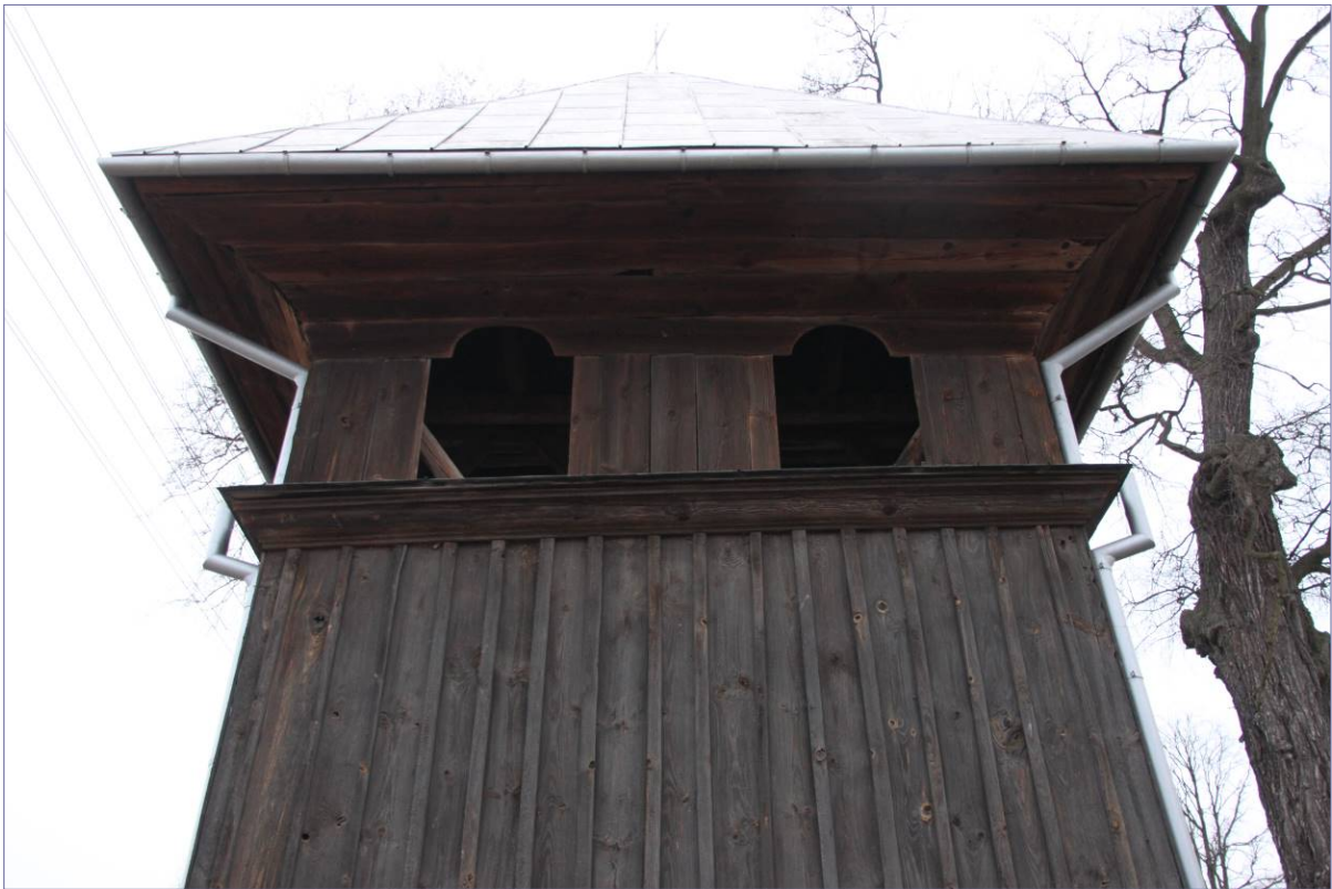
dziury w deskach spowodowane przez dzięcioły, rozluźnienia poszczególnych desek okapu
