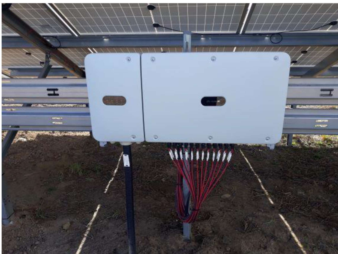
Przykładowy inwerter farmy fotowoltaicznej
